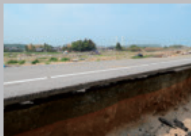
津波で切断された道路 広野町
